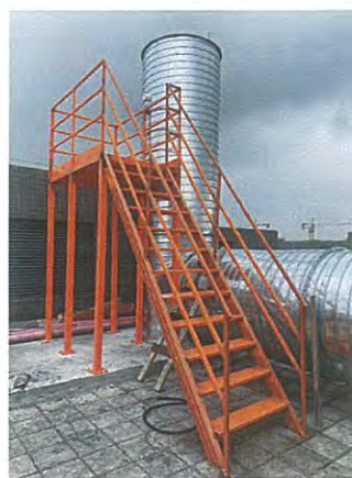
图 5-2b 废气排放口 FQ-18668
